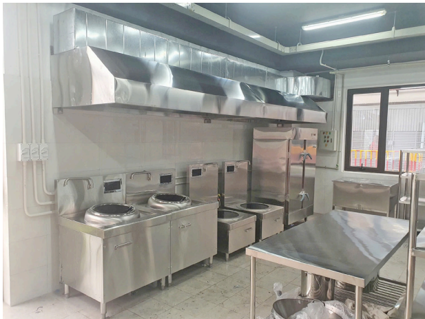
Bếp ăn công nghiệp Công ty GSK (Hà Nội)
